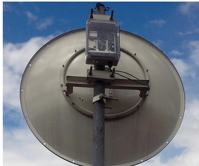
Fig 7 Antena y radio instalados sede XXX Aniv UNINCCA
