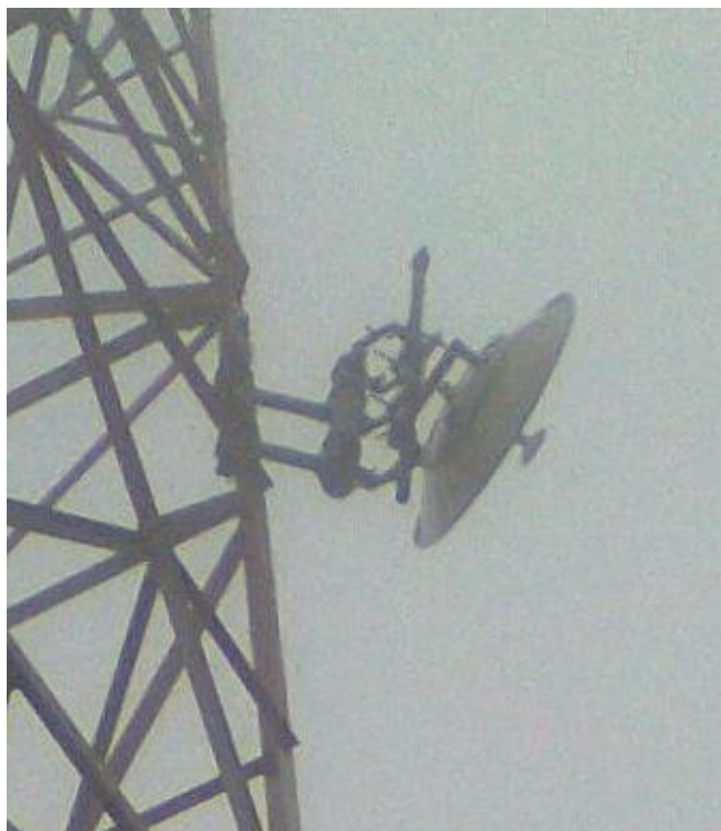
Fig 6 : Antena instalada cerro Manjui
